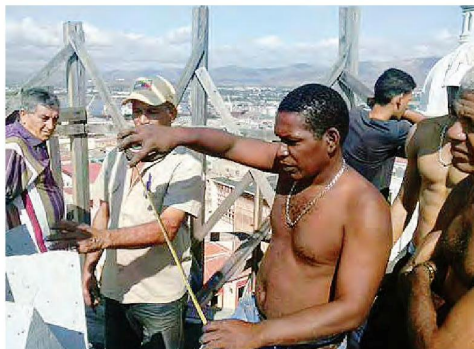
Gli operai della scuola di Macetti al lavoro sul cantiere della cupola
